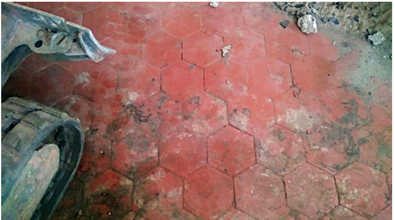
Der unerwartet vorgefundene alte Belag.
