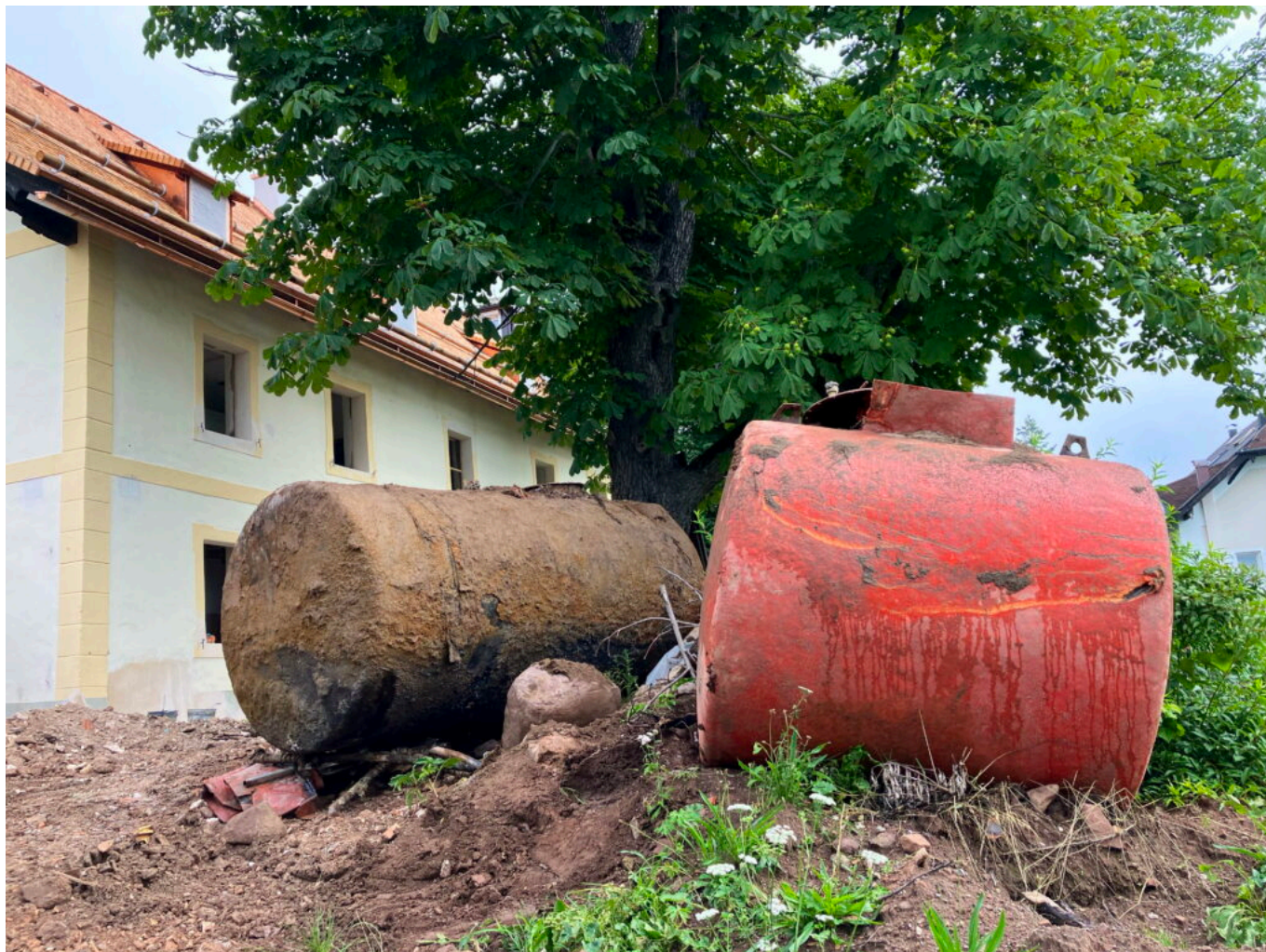
Abb. 1: Links der öltäre, aus Stahl, rechts der neuere, aus Kunststoff bestehende Heizöltank nach dem Ausgraben.
