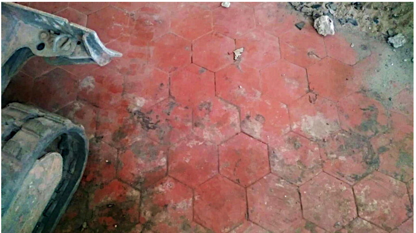
Der unerwartet vorgefundene alte Belag.
