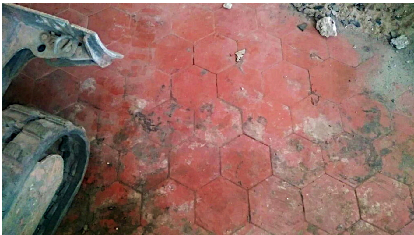
Der unerwartet vorgefundene alte Belag.
