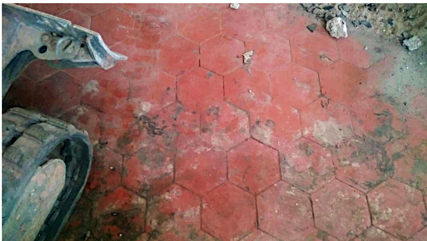
Der unerwartet vorgefundene alte Belag.
