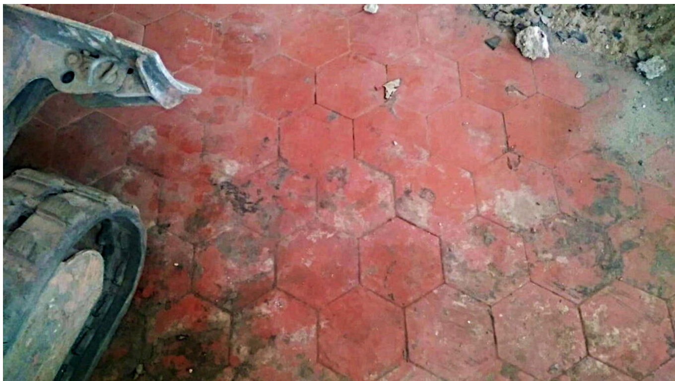
Der unerwartet vorgefundene alte Belag.
